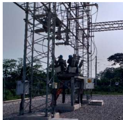
Mantenimiento a interruptor de potencia en subestaciones
