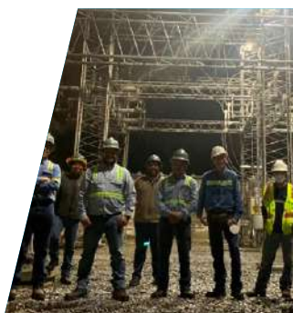
Ampliación subestación Papi Strachan 69 KV
