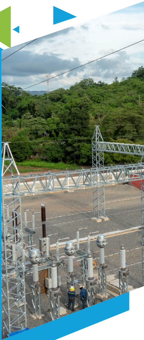
Subestación nueva Pasaco 138/13.8 kV, 14 MVA
