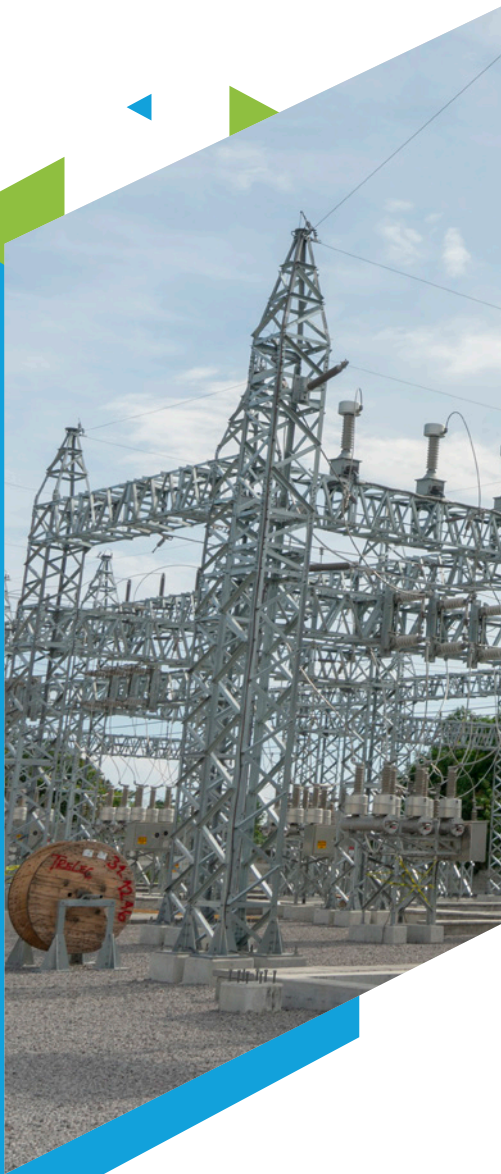
Proyecto Santa Isabel 230 kV
