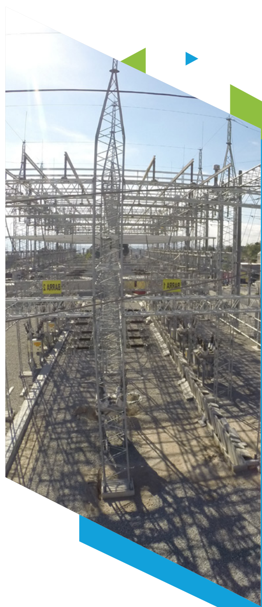
Proyecto Santa Mónica Guatemala Sur 69 kV 3 y 4
